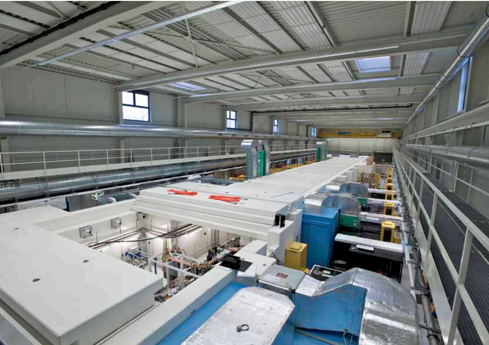
Image (4): Halle de l'injecteur de 250 MeV, installation de test du premier niveau de l'accélérateur pour le projet SwissFEL au PSI.
